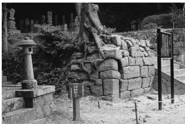
墓所入口の石垣：樹木の生育による歪みと工事準備の状況
